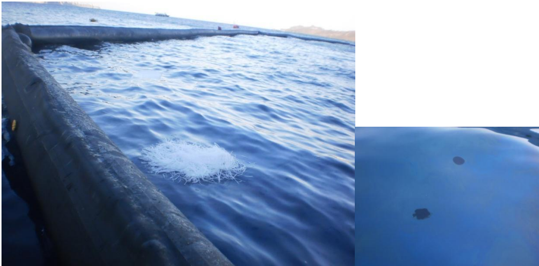
Εικ. 7. Σεπτέμβριος 2012. Το πλωτό φράγμα στην περιοχή του ναυαγίου και το σημείο ανάδυσης της διαρροής
